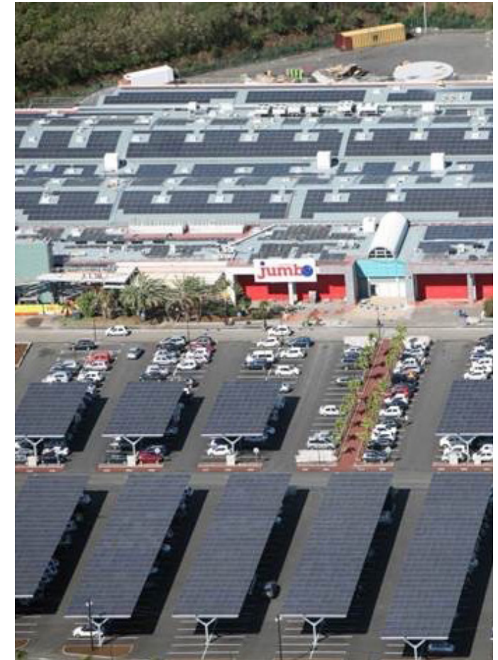
Figura 14.5: Sistema de protección solar y generación de energía fotovoltaica en centro comercial.
