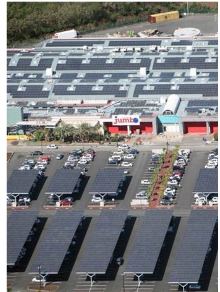
Figura 14.5: Sistema de protección solar y generación de energía fotovoltaica en centro comercial.
