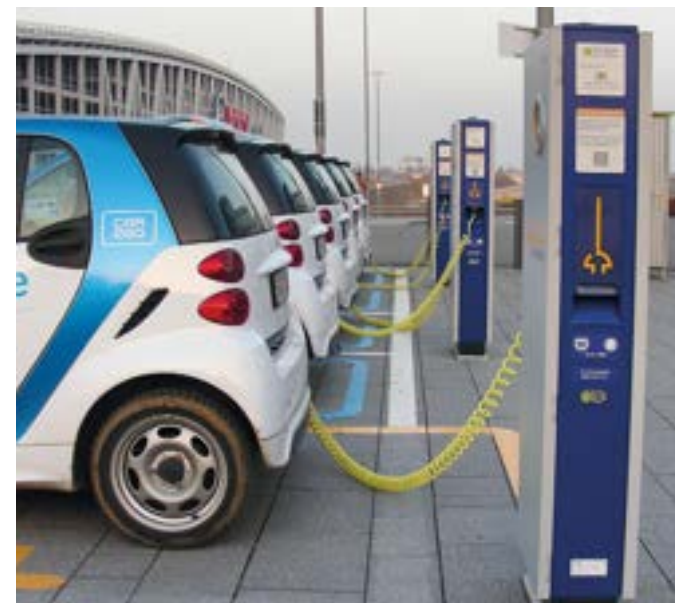
Figura 12.8: Sistema de carga eléctrica para vehículos de servicio público compartido.
